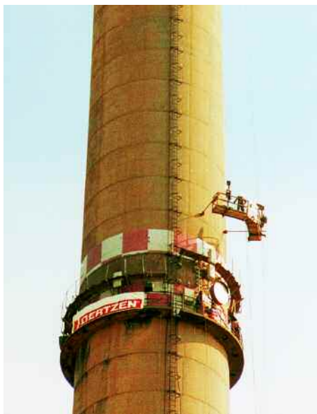
Entfernung der alten Warnmarkierungen an einem 200 m hohen Schornstein mit Wasser-Sandstrahlssystem TORNADO und Hochdruckaggregat E 320 - selbst in 150 m Höhe noch 285 bar!
